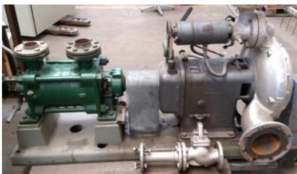
Hochdruckspeisepumpe mit Turbine von Kühnle, Kopp und Kausch (D) 1970 und Gliederpumpe von Sulzer 1969 ex Brauerei Hürlimann Zürich
